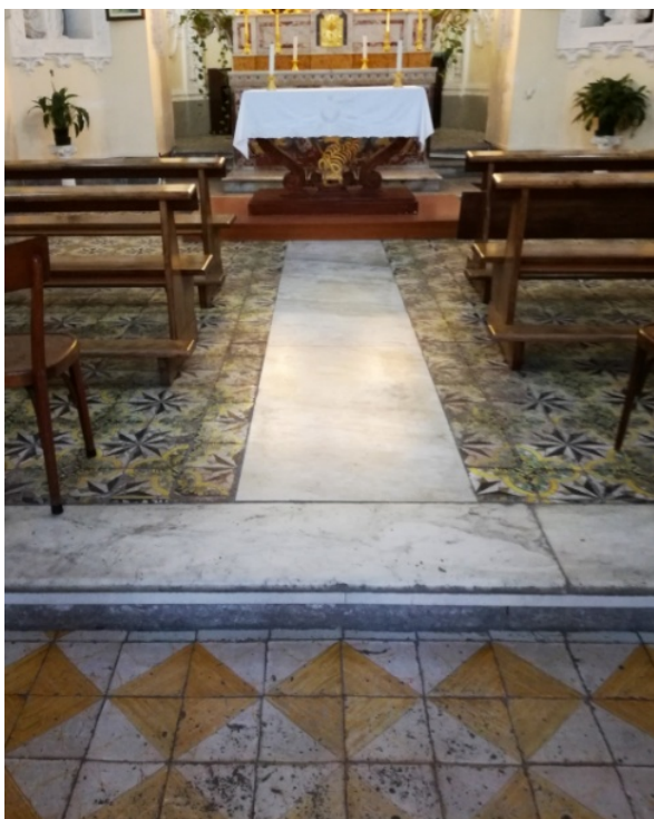
Fig. 4 - Il pavimento della cappella di San Giuliano; nella parte in basso si scorge il pavimento della navata (foto di Marcello Esposito).
